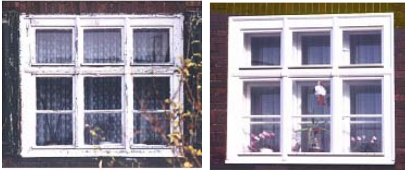
Bild 1: Kastenfenster im Bestand, mit typischen Instandhaltungsmängeln links vor, rechts nach einer fachgerechten Runderneuerung
